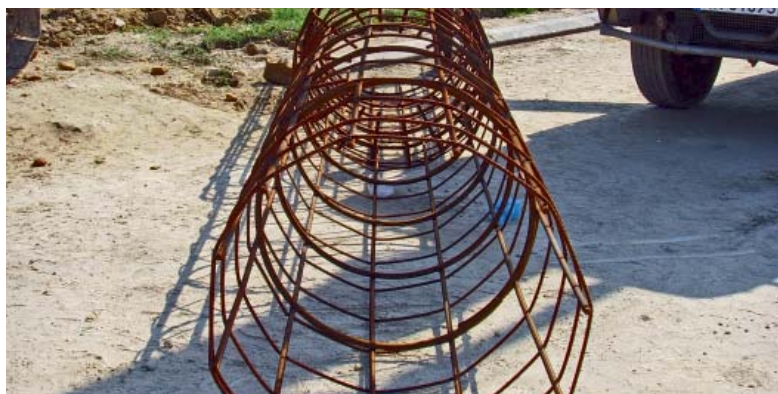
Fot. 13. | Przewężone zbrojenie pała na odcinku zagłębnym w skałę. Budowa Centrum handlowego FELICITY w Lublinie ↑
