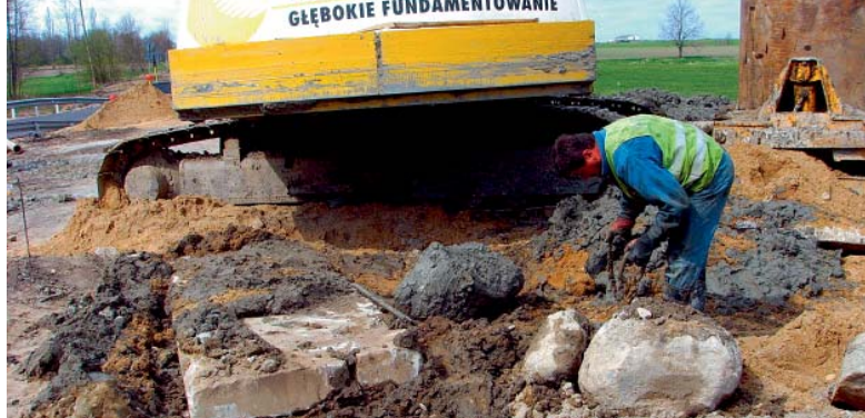
Fot. 10. | Wydobyte z otworu otoczaki granitowe stanowiące przyczółki mostu w m. Wardomy
